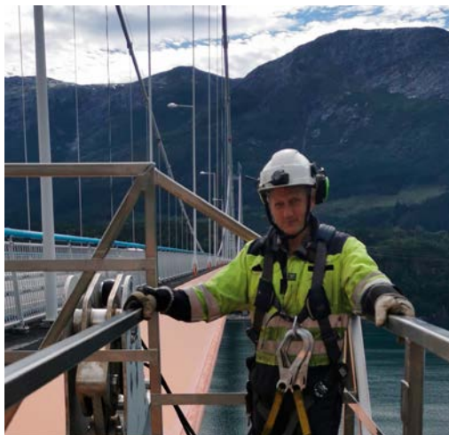
Krantekniker Erlend Raknes (bildet) og senior krantekniker Trond Vidar Faugstad (fotograf) utfører kontroll på Hardangerbroen.
